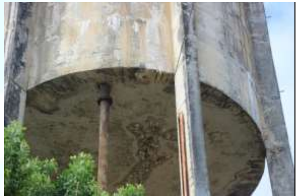
Figura 7. Carbonatação na laje e parede do reservatório
