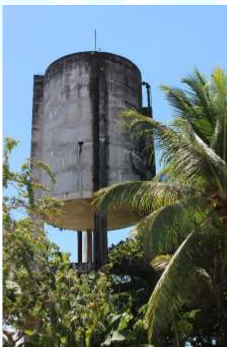
Figura 3. Manchas de vazamento no concreto
