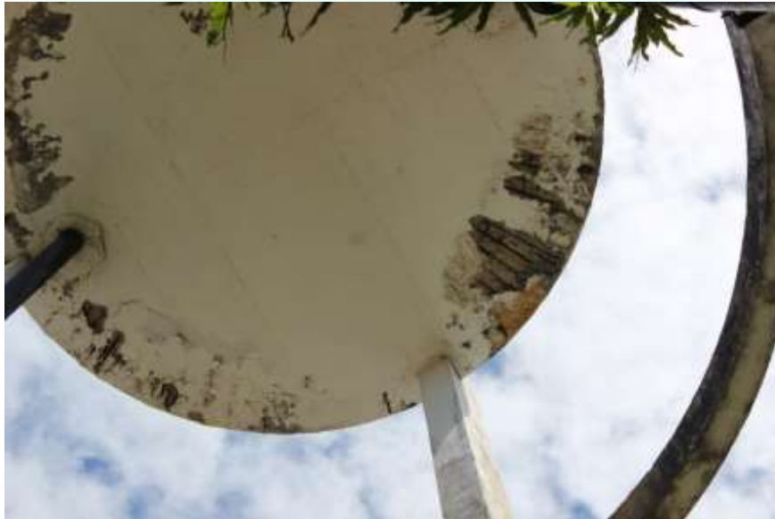
Figura 5. Armadura exposta na laje inferior do reservatório
