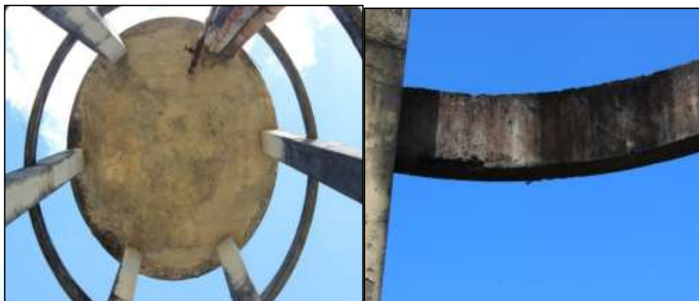
Figura 4. Corrosão de armaduras nas cintas e laje de fundo do reservatório.
