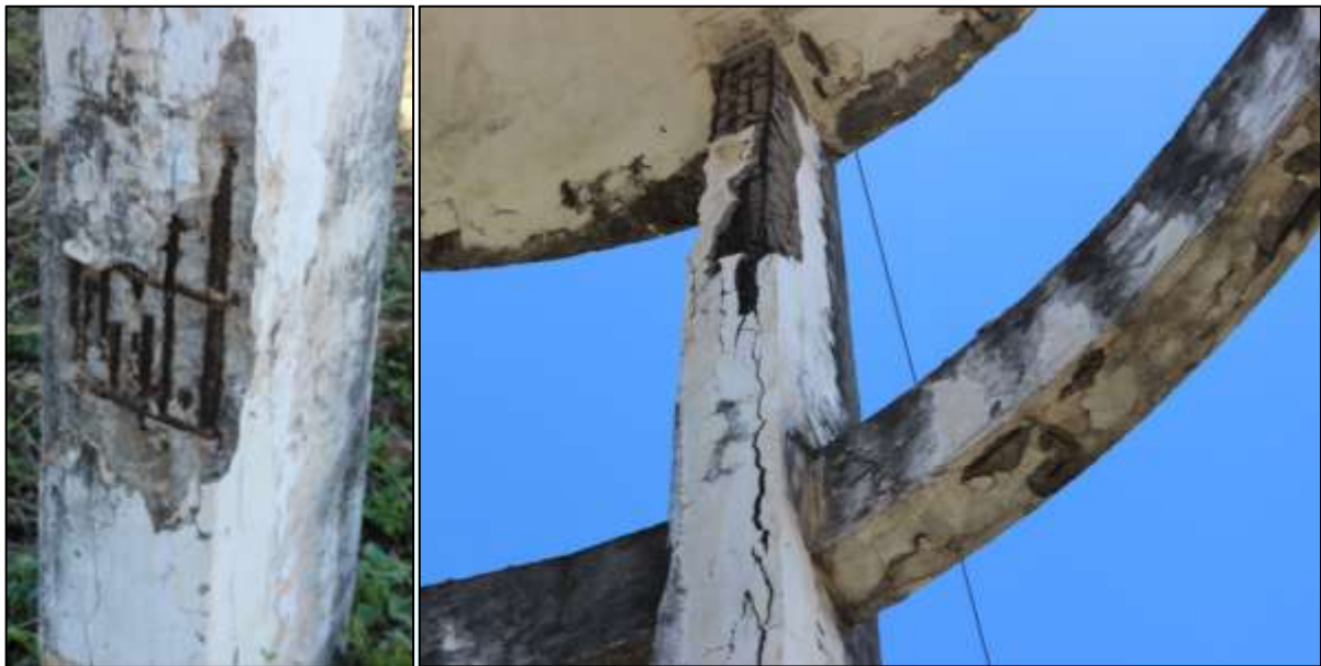
Figura 4. Deslocamento dos pilares, laje de fundo e cintas.
