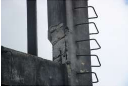
Figura 4. Exposição da armadura no pilar do reservatório
