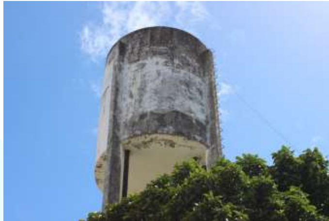
Figura 4. Deslocamento de concreto com exposição de armadura na laje inferior do reservatório
