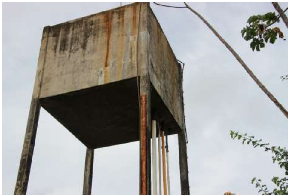
Figura 4. Reservatório com manchas de vazamento
