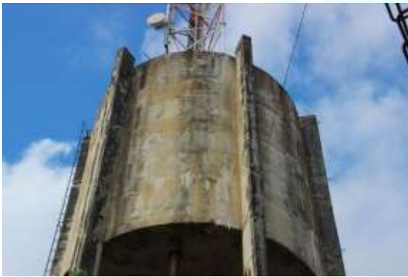
Figura 6. Fissuras na parede do reservatório
