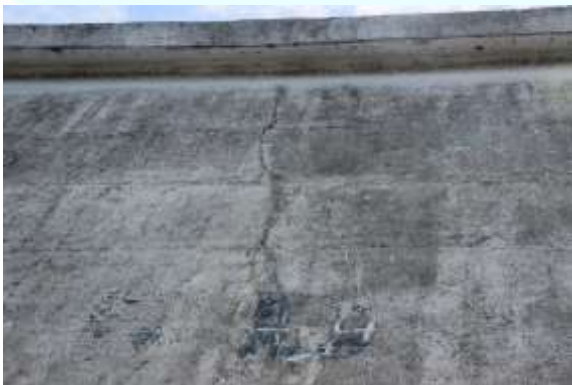
Figura 5. Trinca na parede do reservatório
