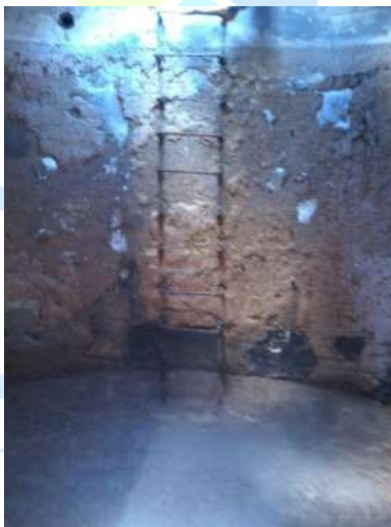
Figura 5. Paredes internas com revestimento inadequado.
