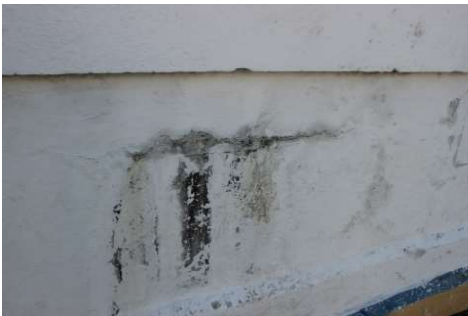
Figura 6. Fissuras nas paredes com mancha de vazamento
