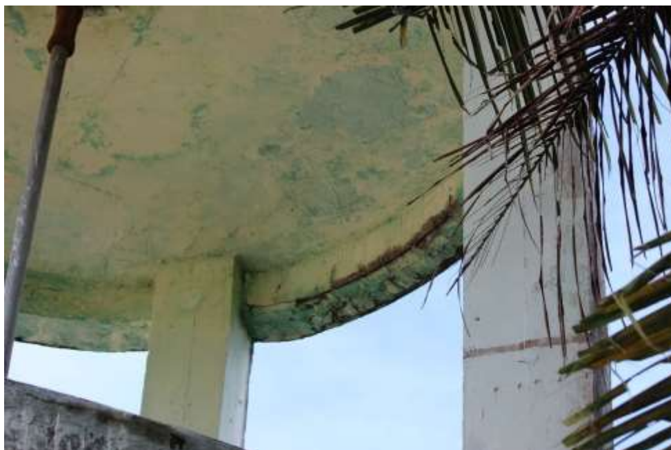
Figura 4. Armadura exposta na viga de fundado reservatório.
