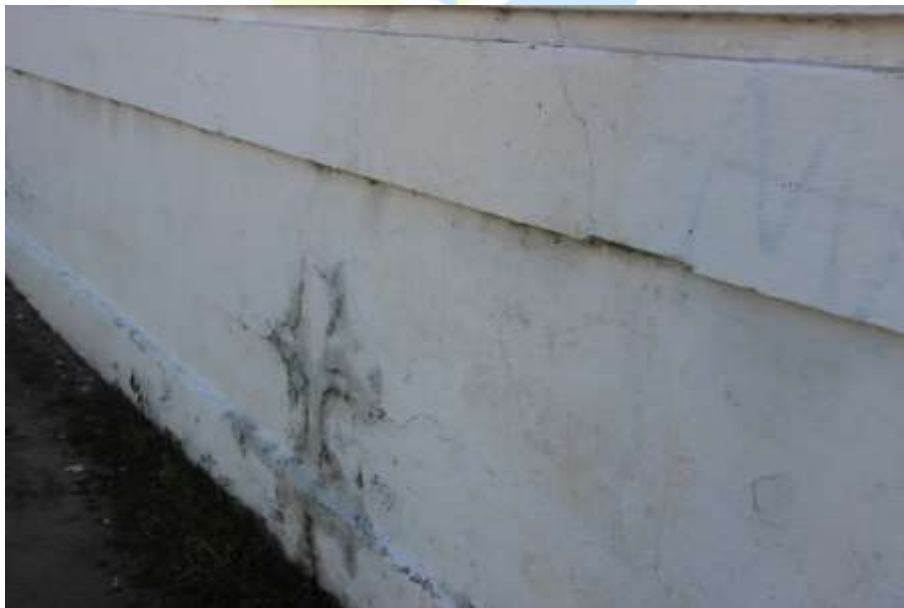
Figura 5. Fissura com vazamento na parede do reservatório
