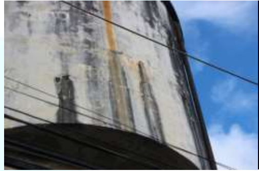
Figura 5. Manchas de vazamento e carbonatação presentes na parede do reservatório
