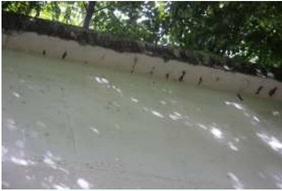
Figura 4. Exposição da armadura
