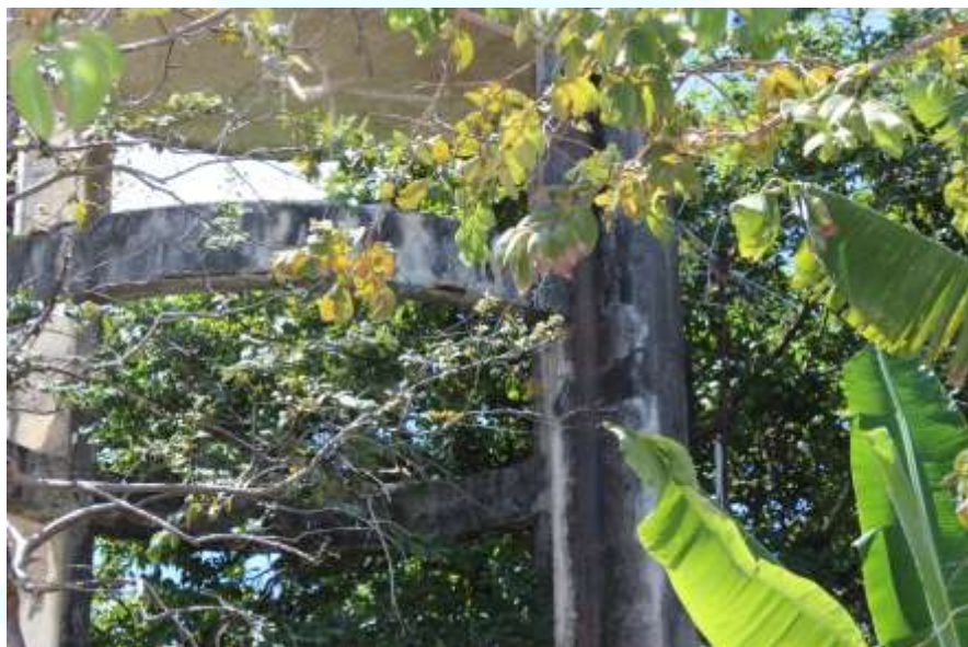
Figura 5. Vigas com armadura exposta
