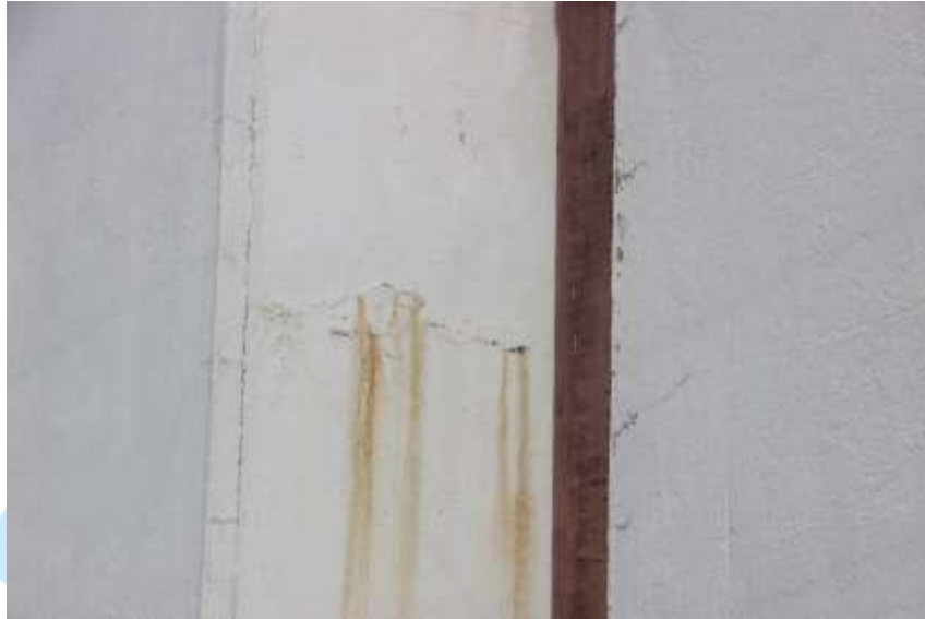
Figura 6. Fissura na parede do reservatório com mancha de vazamento
