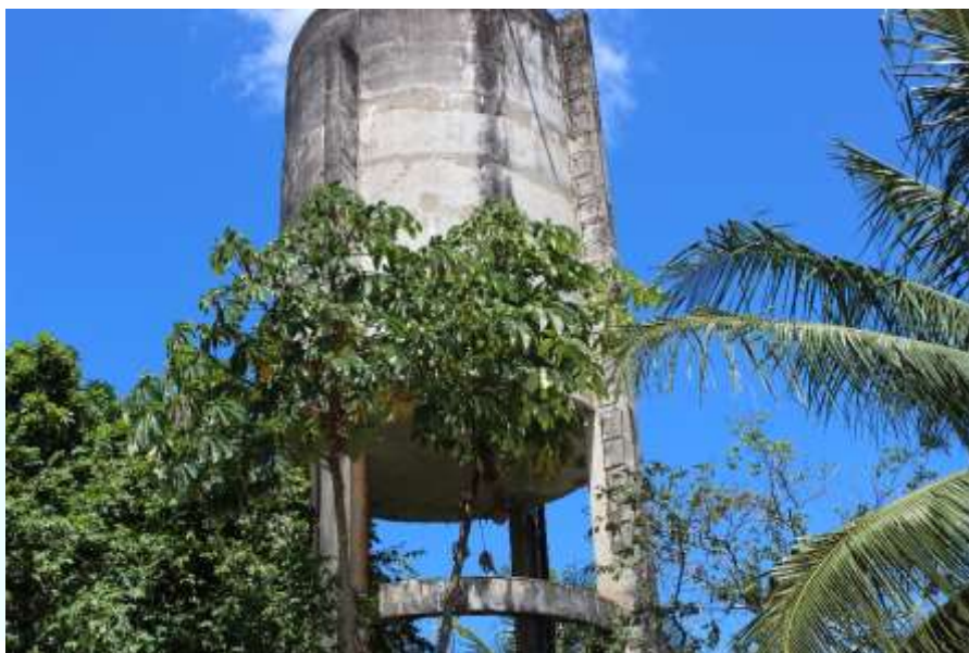
Figura 4. Vista do reservatório com manchas de carbonatação.
