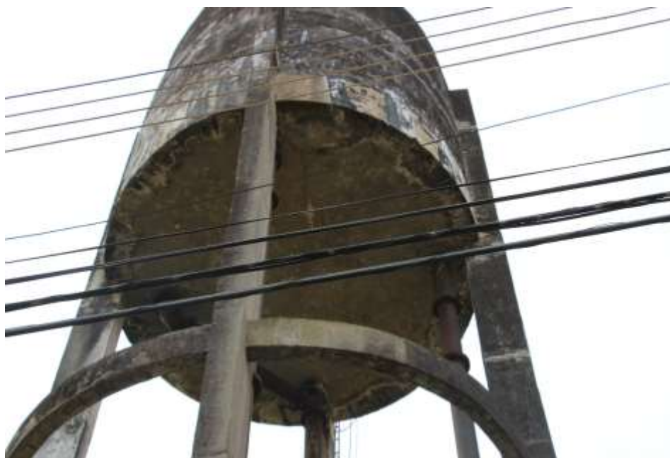
Figura 6. Exposição da armadura na laje de fundo
