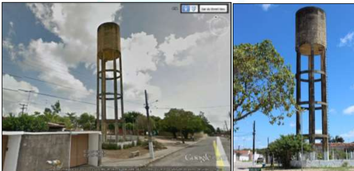
Figura 3. Reservatório do conjunto Inocoop.
