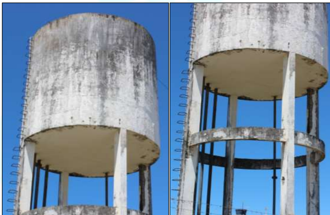
Figura 3. Vazamentos nas paredes do Reservatório.
