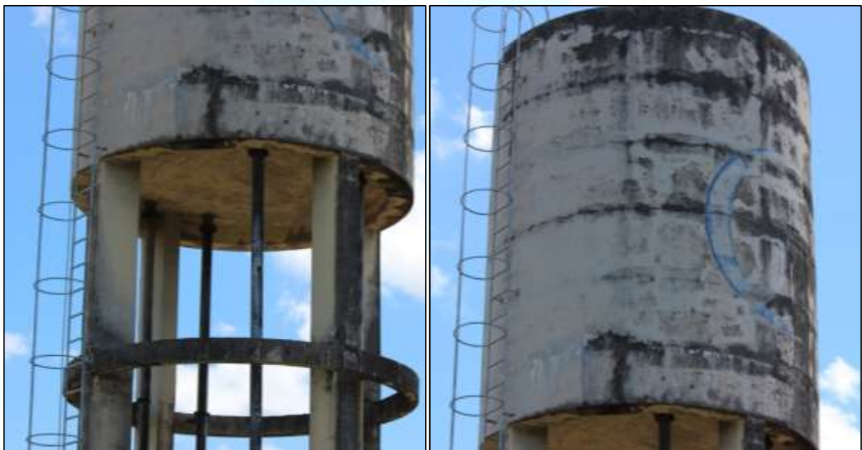
Figura 3. Vazamentos nas juntas de concretagem das paredes do reservatório.
