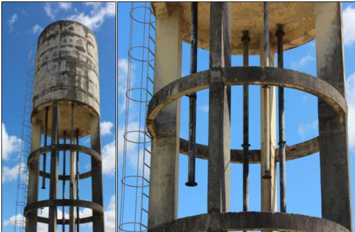
Figura 4. Vazamentos nas juntas de concretagem das paredes do reservatório.
