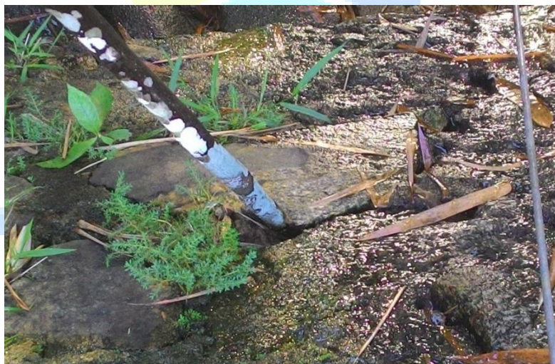
Figura 1- Vazios entre as pedras da alvenaria de que é composto o barramento.
