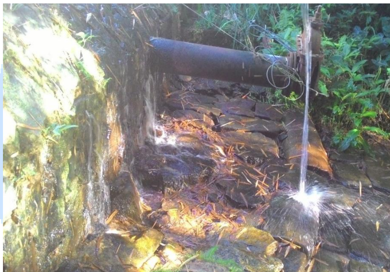
Figura 2- Vazamentos presentes na barragem.
