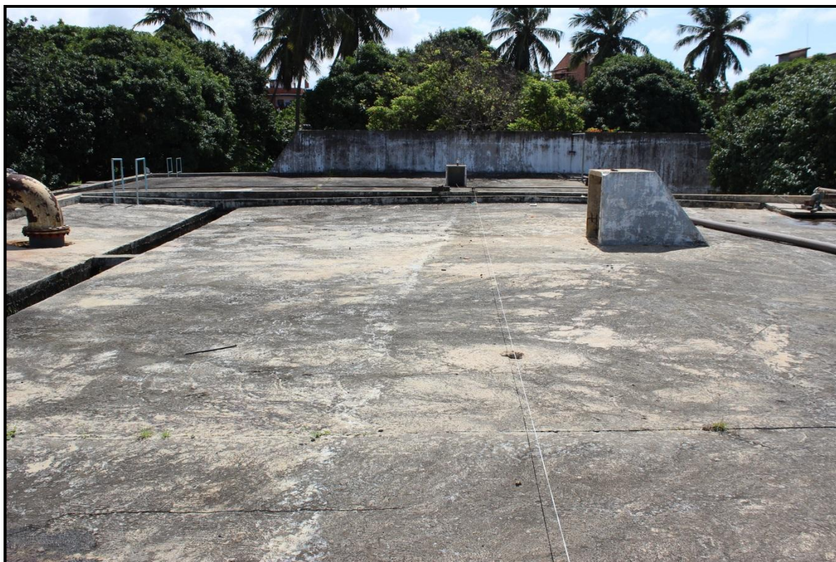
Figura 7. Fissuras na laje
