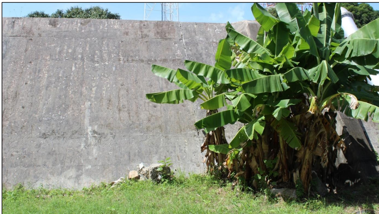
Figura 8. Corrosão de armaduras nas cintas e laje de fundo do reservatório.
