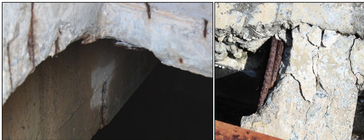
Figura 4. Deslocamento de concreto com exposição de armadura na laje
