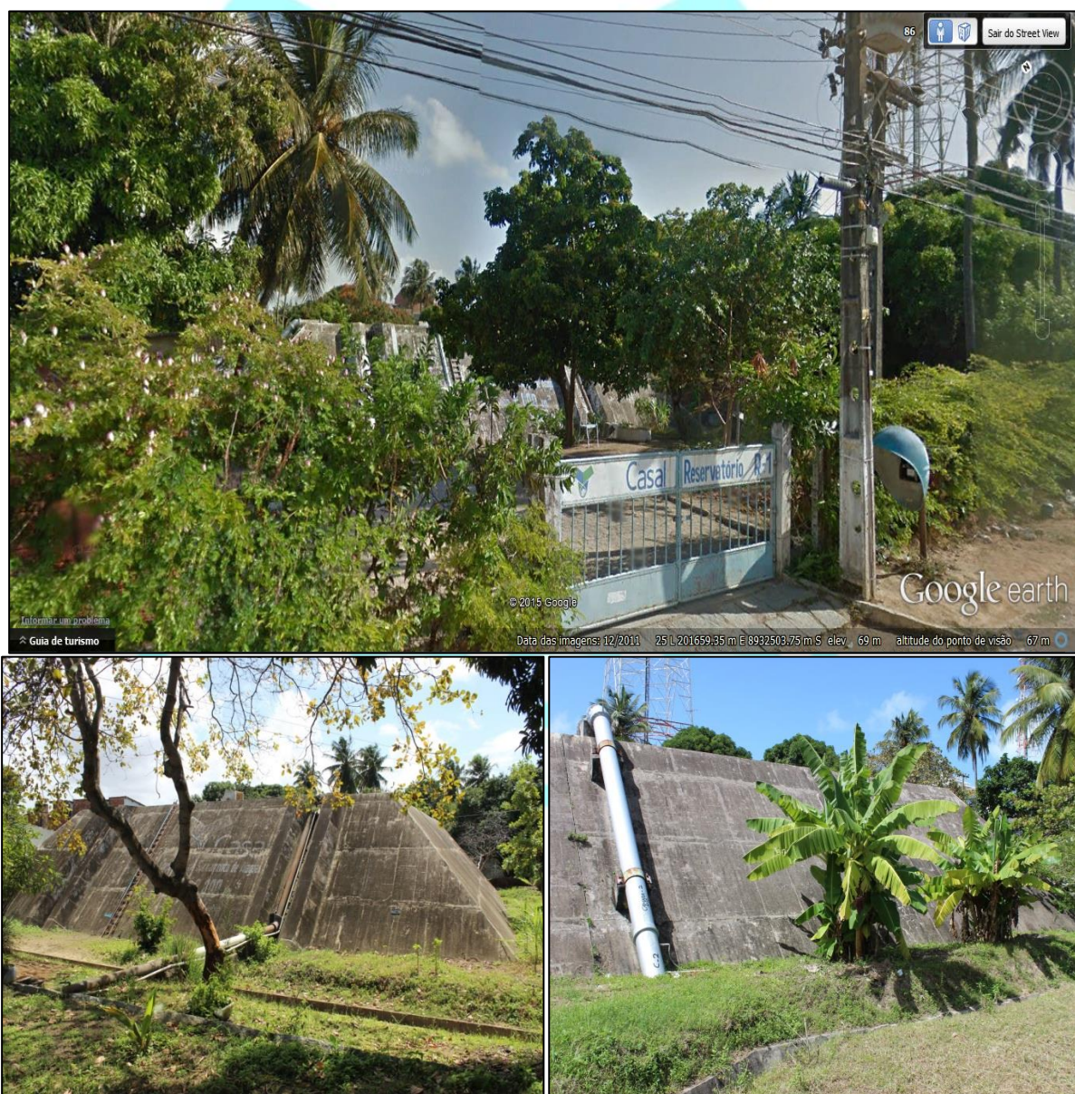
Figura 1. Reservatório R1 no bairro do Jacintinho.
