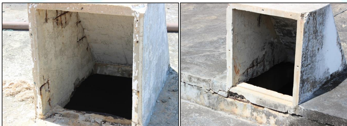
Figura 3. Deslocamento de concreto com exposição de armadura na ventilação
