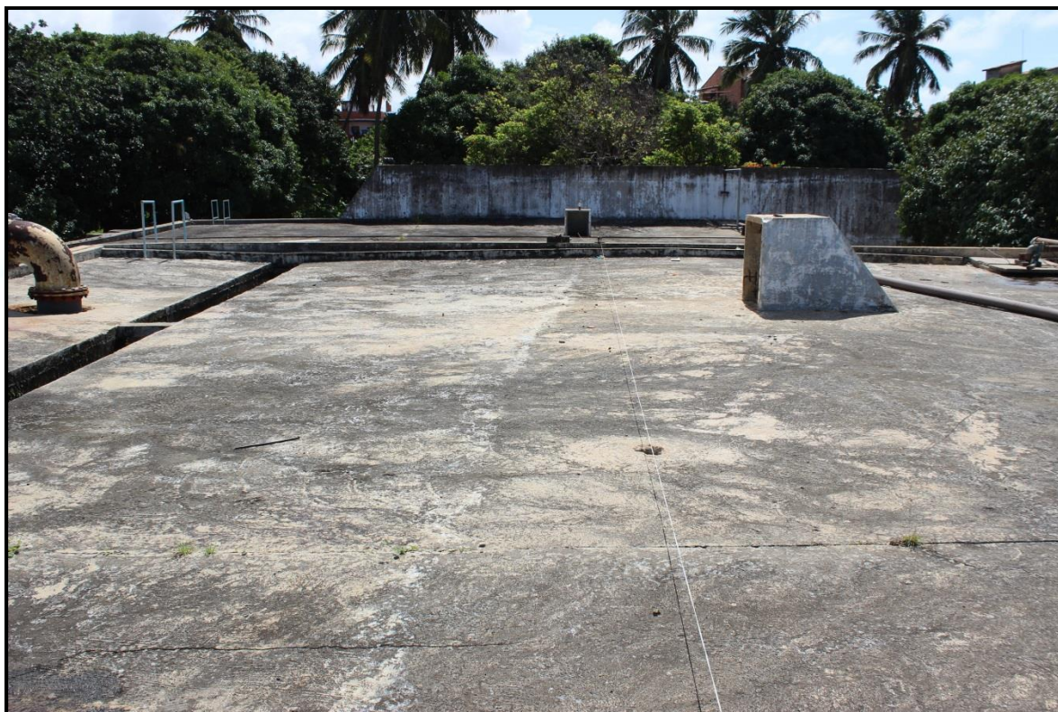
Figura 7. Fissuras na laje
