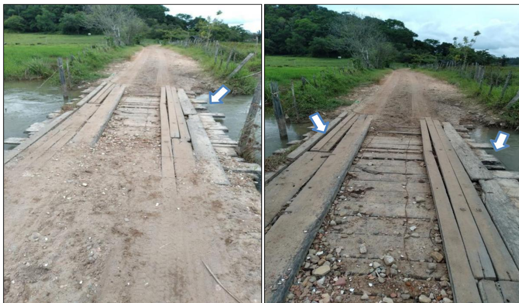
Figura 1. Tabuleiro em madeira com acentuado desgaste (A); irregularidades dos pranchões (B).
