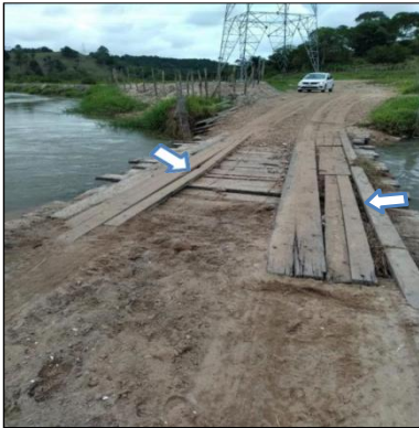
Figura 2. Pranchões deslocados do alinhamento original
