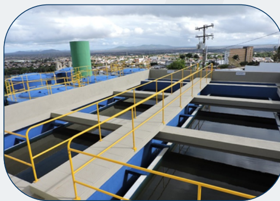
ETA de Palmeira dos Índios - AL recebe água do Sistema Carangueja
