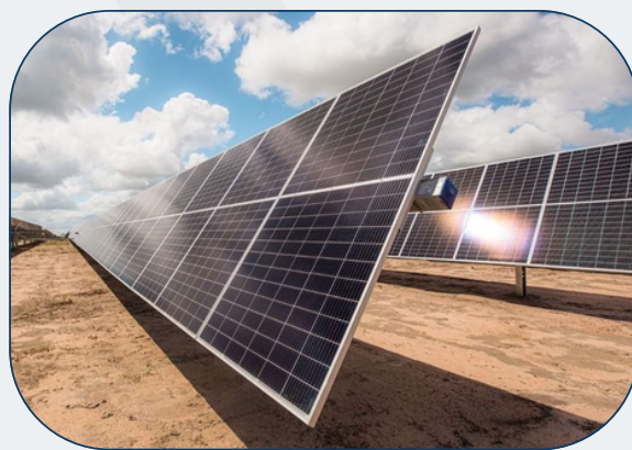
Usina Fotovoltaica Coruripe- AL
